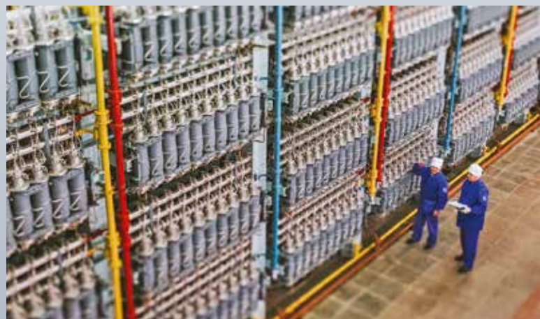
Машинный зал технологического цеха АО «УЭХК», г. Новоуральск
